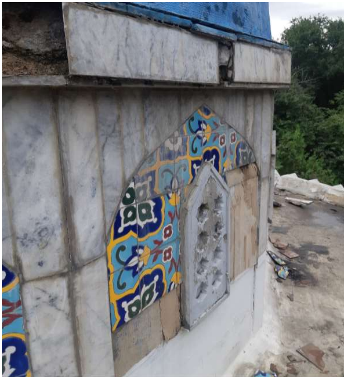
Кровля и купол мавзолея до научно-реставрационных работ
