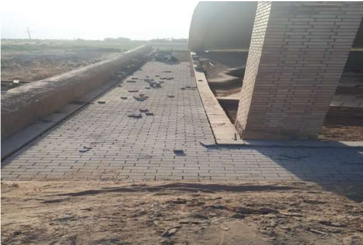
Устройство смотровых дорожек и обзорной площадки. Изготовление решетчатых конструкций в построчных условиях и на производственных базах смотровой дорожки №1
