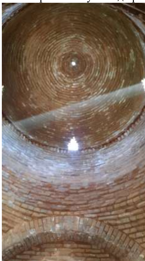
Внутренняя поверхность купола до реставрации
