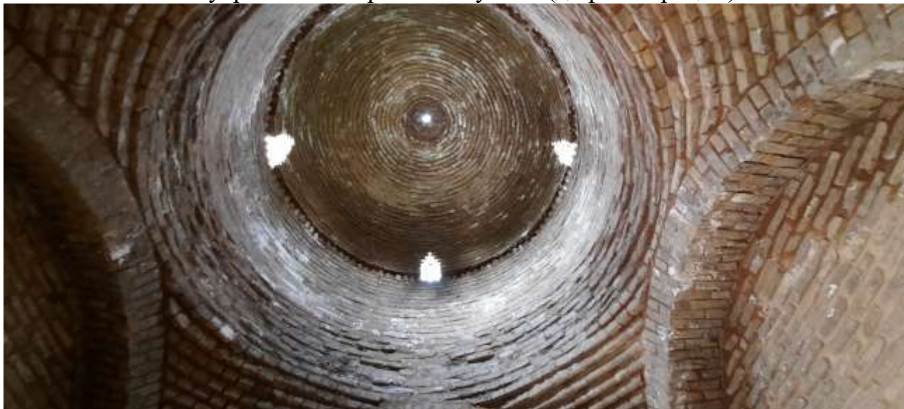
Внутренняя поверхность купола (до реставрации)
