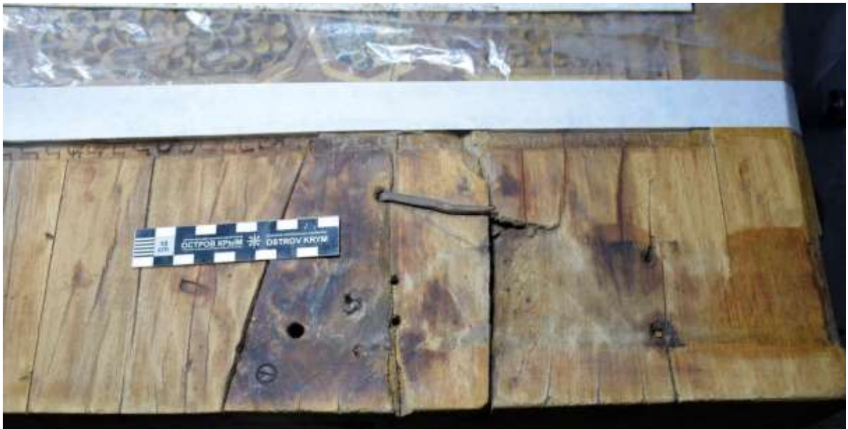
След от металла почищен
